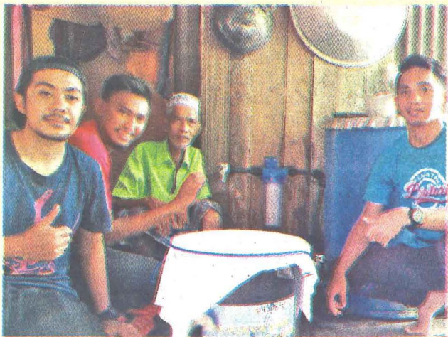
PELAJAR melakukan pemasangan Ceramic Water Filter di salah sebuah rumah penduduk kampung.
